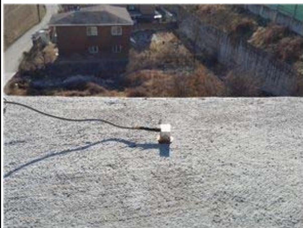
가속도계 설치 현황
