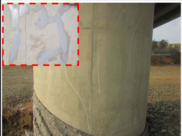
교각 균열(폭 0.2mm)(보수완료)
