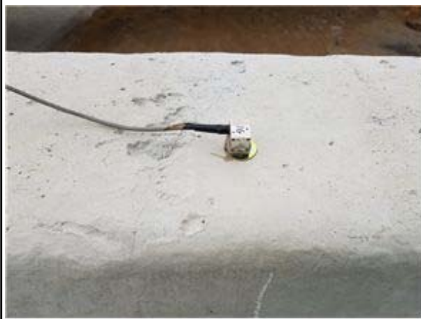
가속도계 설치 현황
