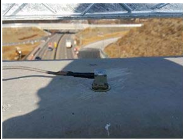
가속도계 설치 현황
