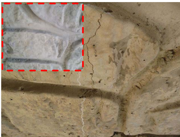
교대 A1 균열(폭 0.3mm미만)(보수완료)
