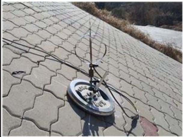
처짐계 설치 현황
