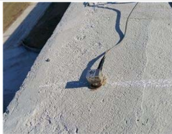
가속도계 설치 현황
