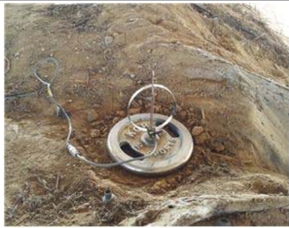
처짐계 설치 현황
