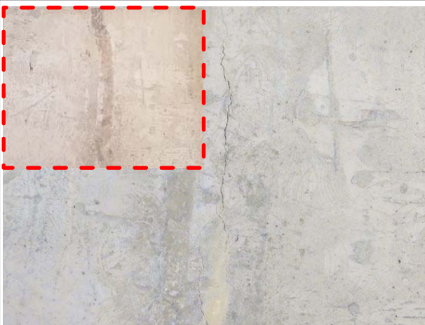
교대 A1 균열(폭 0.3mm)(보수완료)
