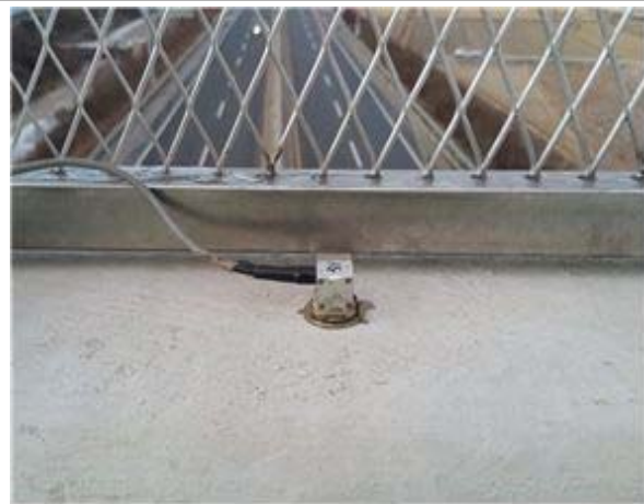
가속도계 설치 현황
