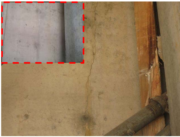
교대 A1 균열(폭 0.3mm)(보수완료)
