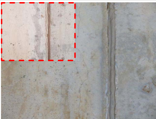
교대 A1 균열(폭 0.1mm)(보수완료)
