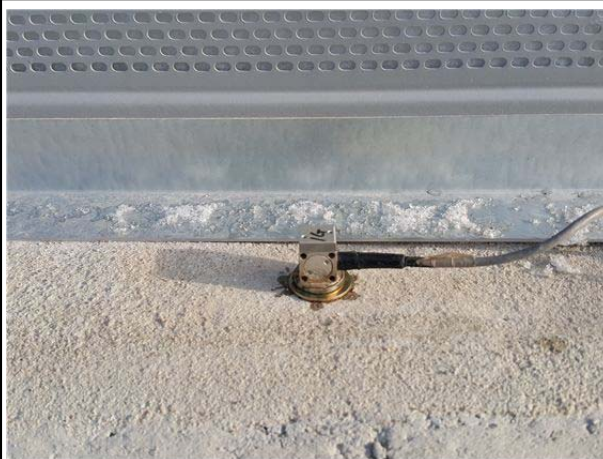
가속도계 설치 현황
