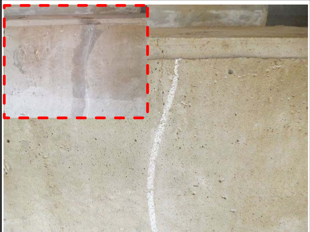
교대 A2 균열(폭 0.1mm)(보수완료)
