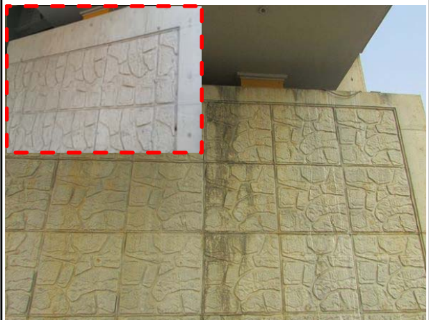
교대 A2 전면벽체 표면오염(보수완료)
