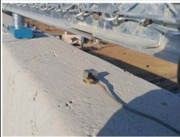
가속도계 설치 현황
